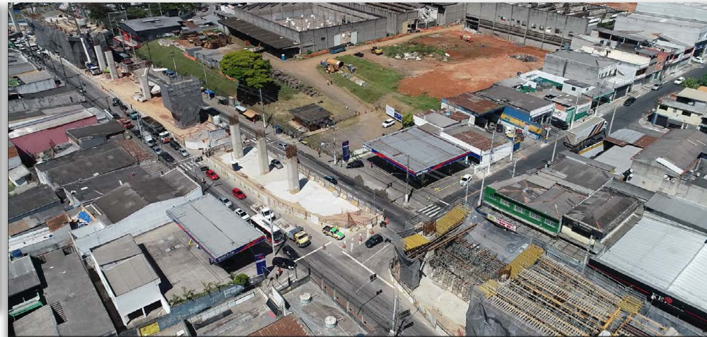
Pilares e deck switches ao longo da Av. Ragueb Chohfi
