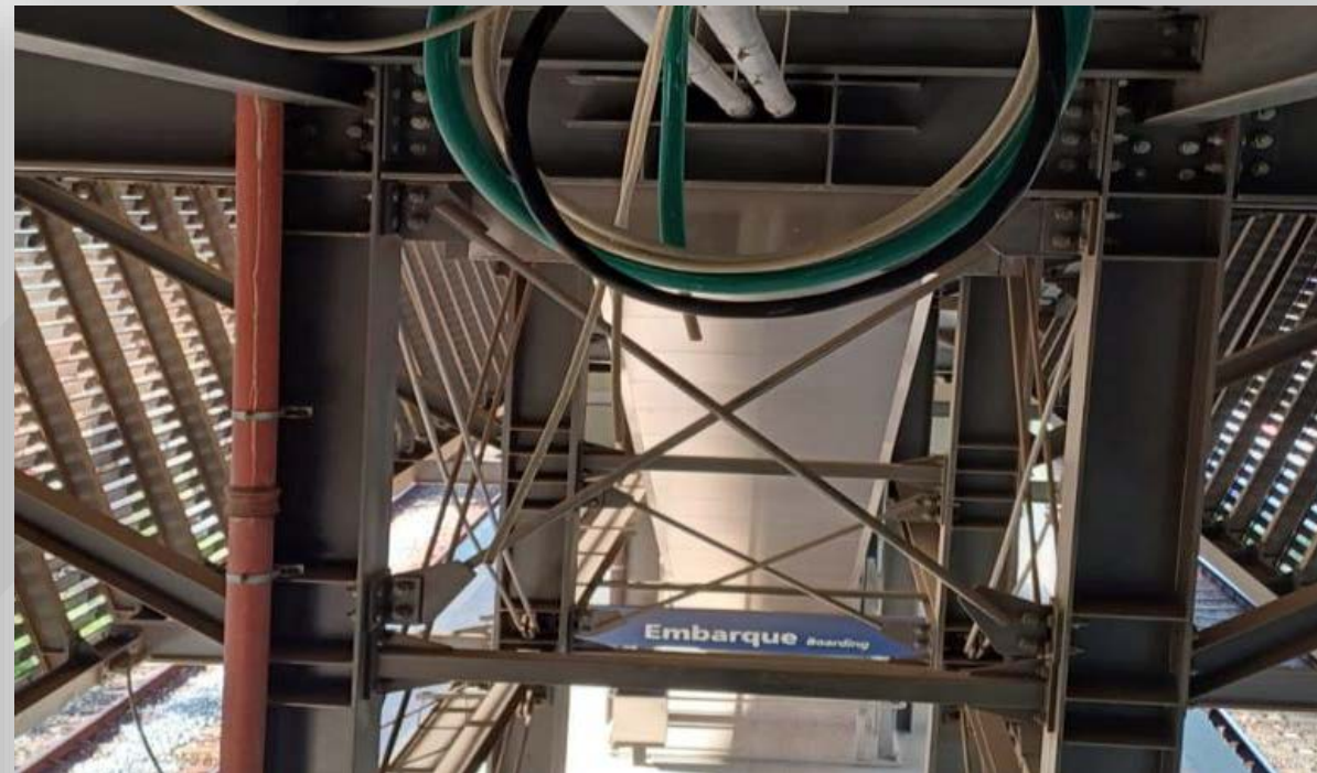
Passagem de cabos de potência e comandos das escadas rolantes na região de integração com a Linha 9
